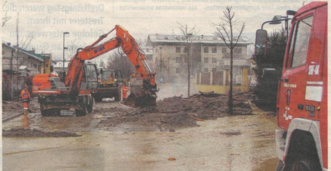
Komplett verlegt wurde die P 311 in Schüttdorf durch einen Murenabgang beim Hotel Alpenblick. Feuerwehrleute konnten sich im letzten Moment vor der gewaltigen Geschiebemasse retten. Bild: SW/FF ZELL AM SEE
